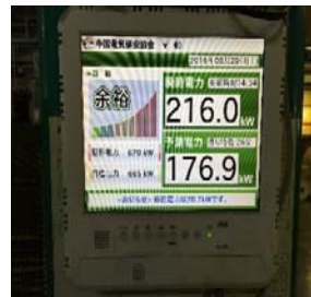
【⑩デマンド装置デジタルタイプの設置】
